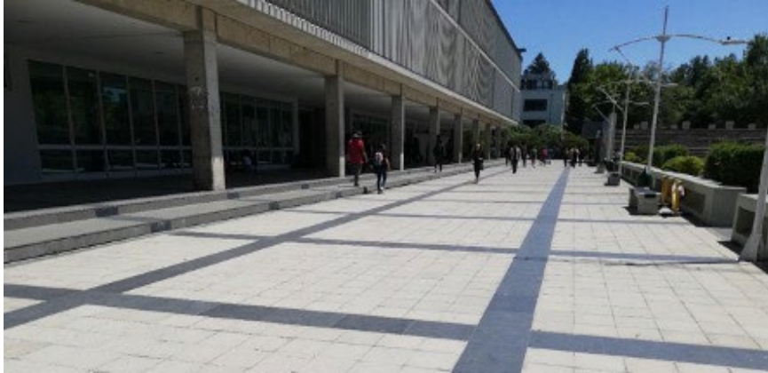
Figura 10. Desnivel generado en el nuevo edificio de Química. Fuente: elaboración propia
