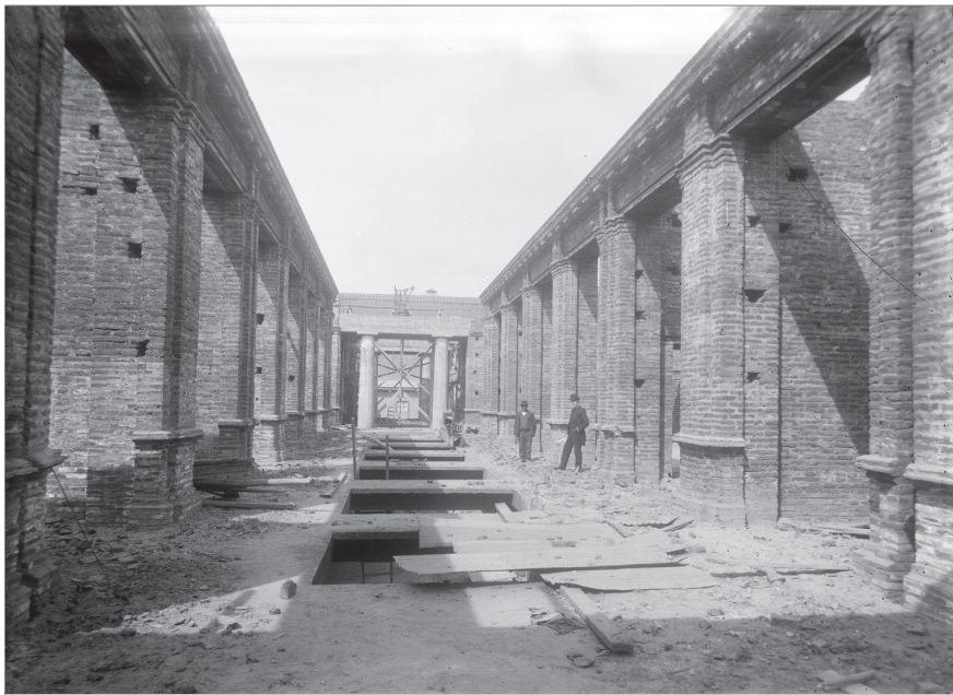
Figura 5. Primera fase del Palacio de los Tribunales de Justicia en construcción. Muros realizados en albañilería de ladrillo con refuerzos metálicos.
