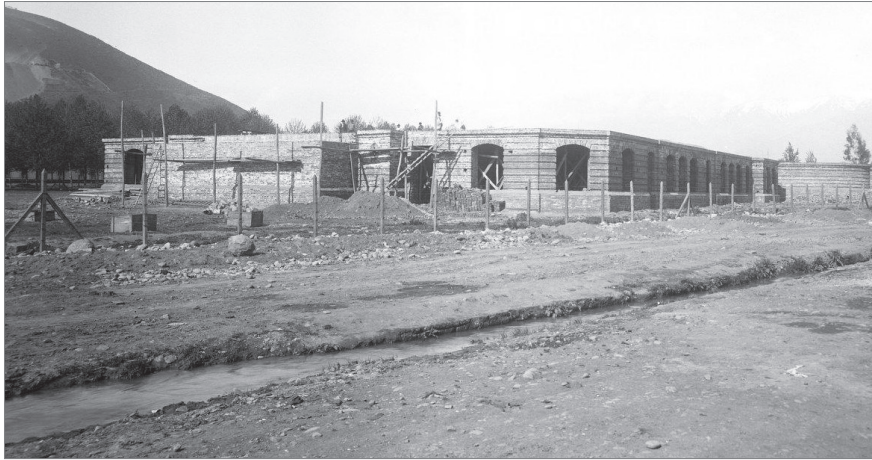
Figura 3. Primer piso del Museo y Escuela de Bellas Artes en construcción. Los gruesos muros son realizados en albañilería tradicional reforzados con piezas de hierro.
