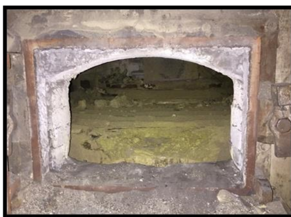
Figura 2. Foto real de una puerta en un nivel del horno.
