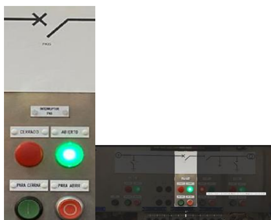
Figura 3. Unidad de operación de panel de control de interruptor.
