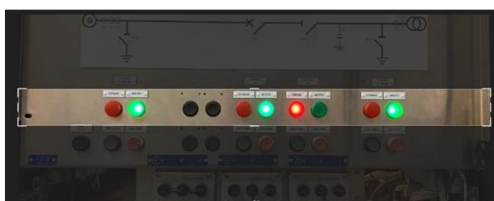
Figura 5. Reconocimiento espacial de estado del sistema en tablero de comando de interruptor
