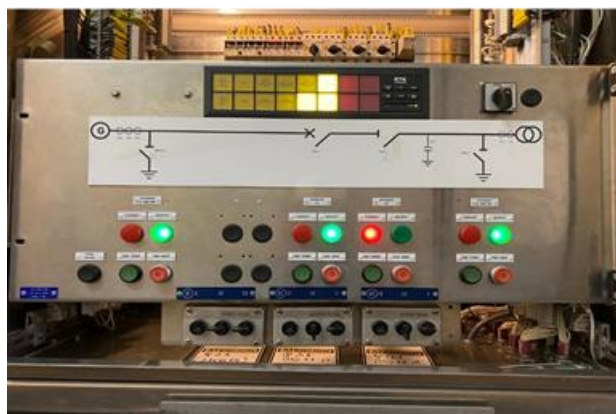
Figura 1. Panel de control de interruptor.
