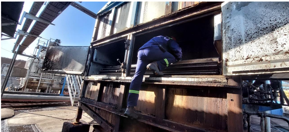
Figura 1. Acceso a horno para desincrustar las bandas.
